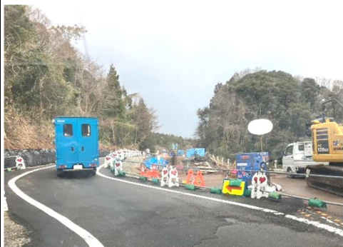
「のと里山海道・穴水町」3月13日 一方通行だが、どんどん補修は進んでいる
